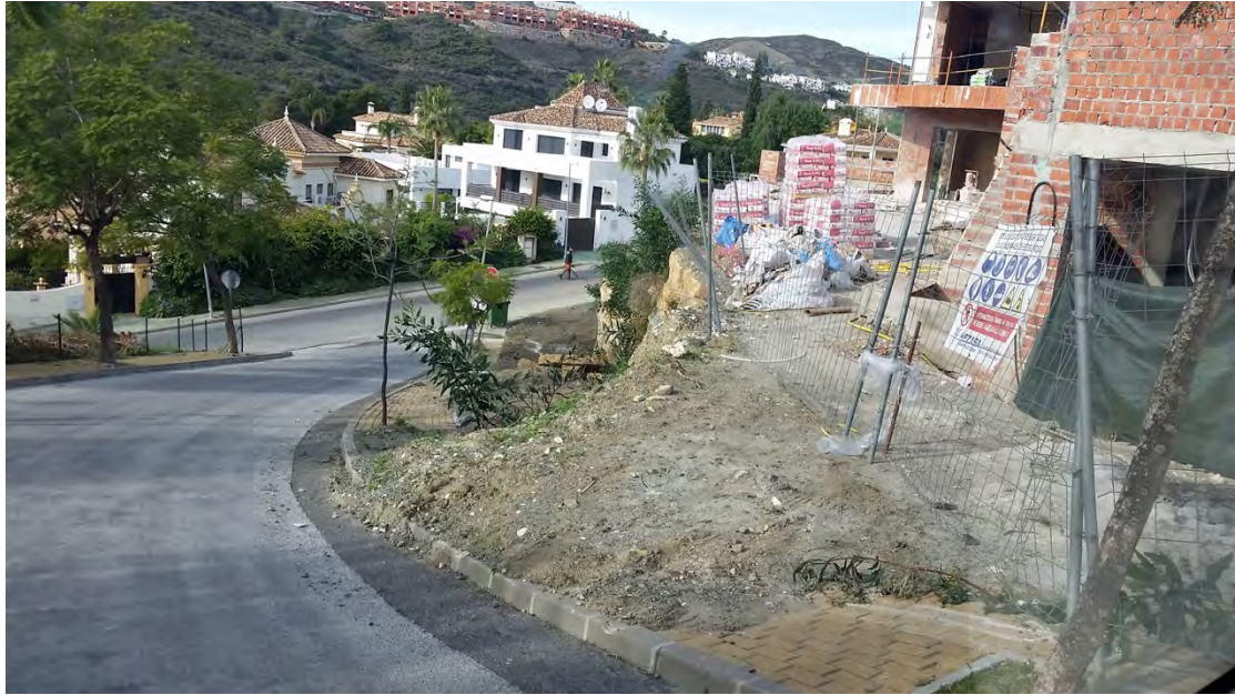
Foto 3. Aceras de viales ocupadas por obras ocultando posibles hidrantes.
