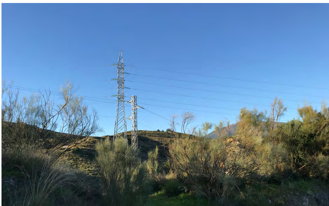
Foto 6. Tendido eléctrico de alta tensión al norte de la urbanización bajo matorral.
