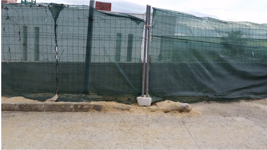
Foto 1. Aceras de viales ocupadas por obras ocultando posibles hidrantes.
