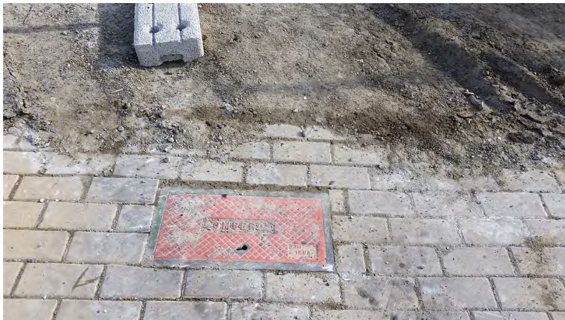
Foto 7. Hidrante en vial sin señal vertical. Se aprecia que ha estado tapado por restos de obra.
